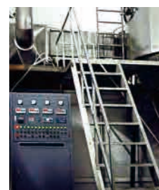
控制系统 Control System
